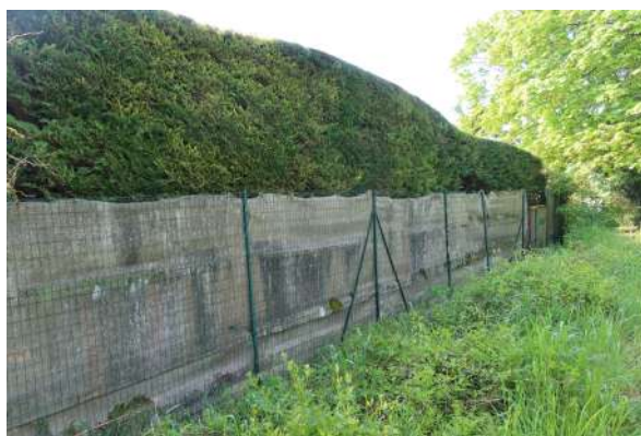
Danger maximum ici avec la présence de thuyas et d'un brise vue en matière synthétique. © ASCM
